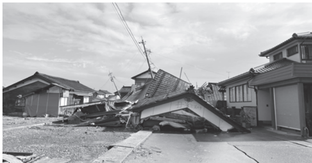
写真1 倒壊したままの家屋
